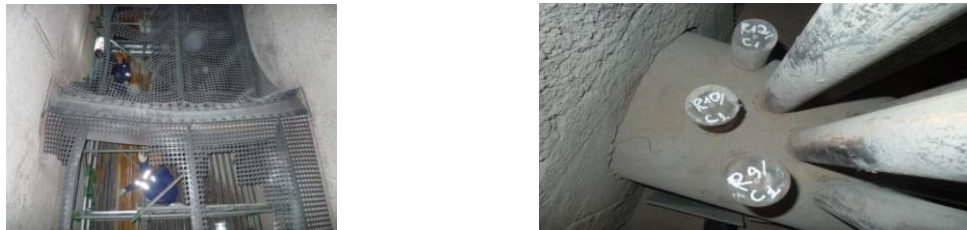
Hình 23. Vị trí ống quá nhiệt bị nổ.
