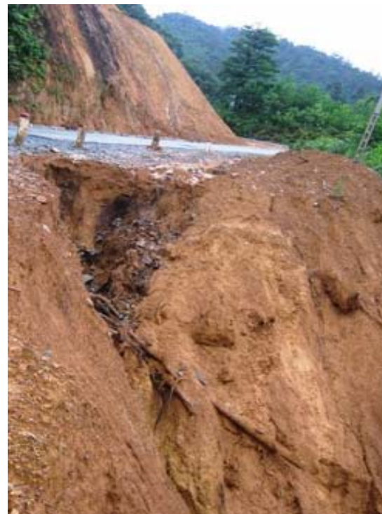
Hình 4. Trượt lở taluy âm tại km71+500 (A Roàng, TT Huế, 2011)
