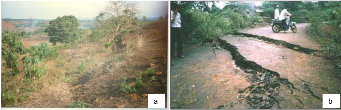
Ảnh 2. Nứt sụt đất ở Hoà Thắng - Buôn Ma Thuột (a), Quảng Tín - Đắk Lắk (b) (ảnh Phạm Văn Hùng)
