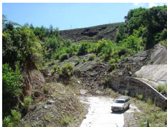
Ảnh 4. Trượt lở đất tỉnh lộ 626, xã Trà Thọ, huyện Tây Trà (ảnh: Phạm Văn Hùng, năm 2012)
