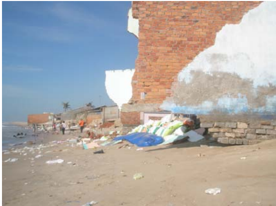
Ảnh 4. Xói lở tại bờ nam cửa La Gi (3/2009)
