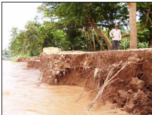
Hình 4. Xói lở tại đầu cù lao Long Khánh (2006)
