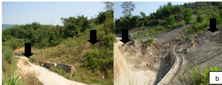
Ảnh 1. a-Nứt sụt đất TL623 tại Trà Lãnh, huyện Tây Trà b-Nứt sụt đất TL626 thuộc thôn Bắc Dương, xã Trà Thọ, huyện Tây Trà (ảnh Phạm Văn Hùng)
