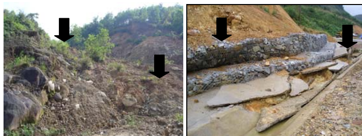
Ảnh 2. Nứt sụt đất tại làng Hót và thôn Trà Xanh (xã Trà Lâm, huyện Trà Bồng) (ảnh Phạm Văn Hùng)
