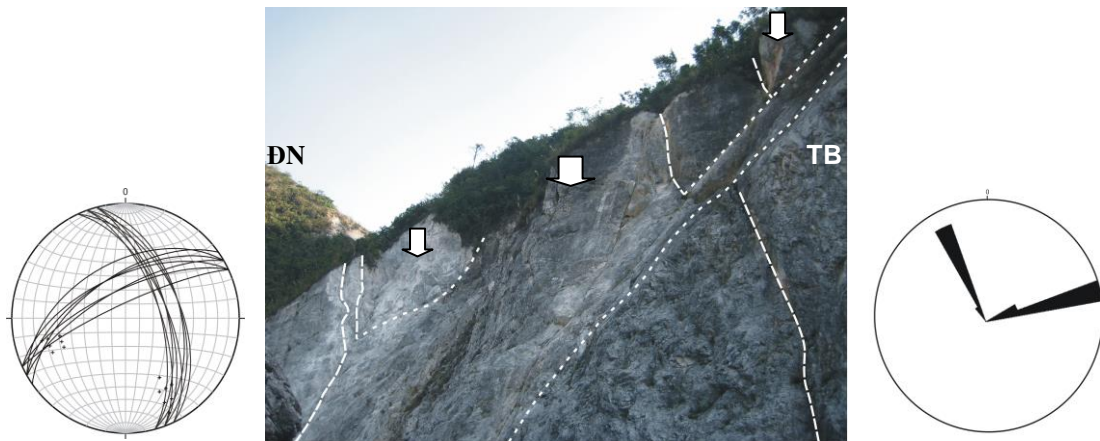
Hình 4. Khối đá vôi có nguy cơ trượt dạng nêm tại điểm Thung Khe 2. Đỉnh khối trượt cao 60m. Điểm nhọn phía dưới của nêm trượt lớn cách mặt đường 15m, đuôi nêm trượt (phần đỉnh dốc) rộng 40m. Cung đường 110°. Các mặt gián đoạn thể hiện trên lưới chiếu (trái) và biểu đồ hoa hồng (phải) cho thấy có hai phương cấu trúc chính
