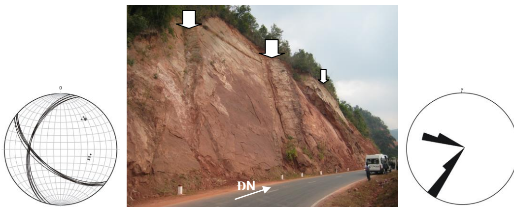
Hình 12. Tính phân lớp của các đá thuộc hệ tầng Yên Châu tại sườn dốc có đường phương song song với tuyến đường. Mũi tên nhỏ chỉ khối bị mất chân có nguy cơ trượt phẳng, chân khối nhỏ đã trượt. Hai mũi tên lớn chỉ vị trí giao của các loại mặt gián đoạn lớn có mặt tại sườn dốc. Các mặt gián đoạn thể hiện trên lưới chiếu (trái) và biểu đồ hoa hồng (phải) cho thấy có hai phương cấu trúc
