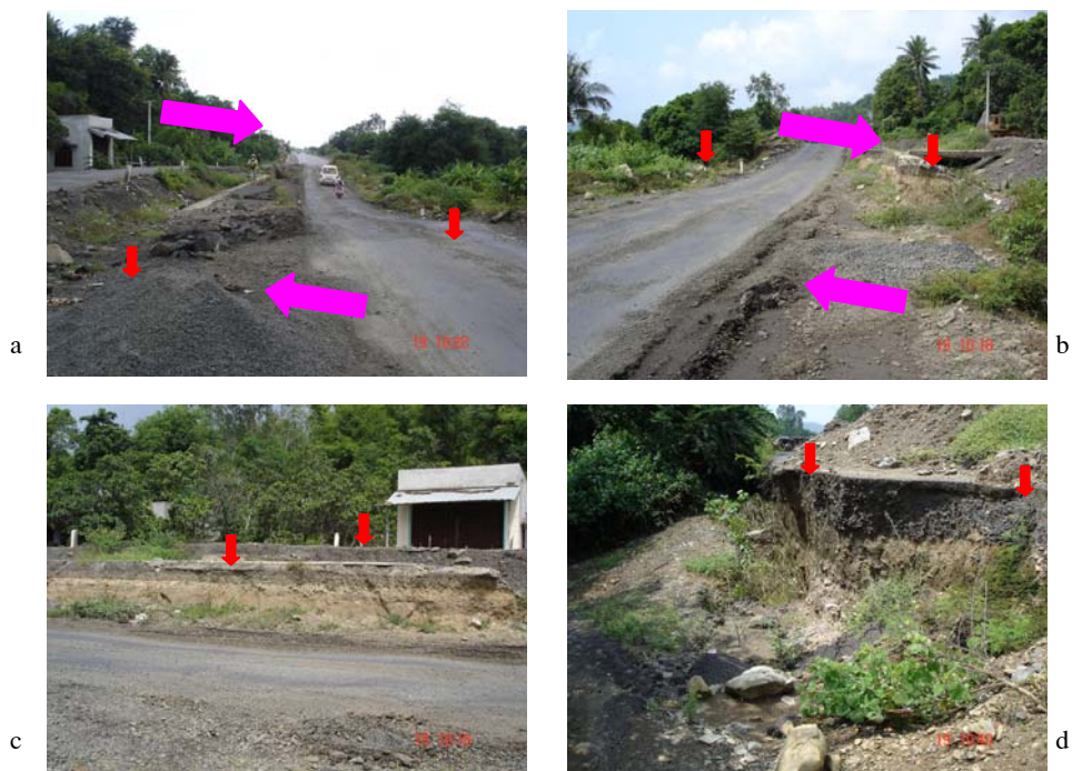
Ảnh 6. Biểu hiện hoạt động hiện đại của đống đất gãy Sông Côn tại điểm cắt qua QL1A thuộc xã An Dân, huyện Tuy An, tỉnh Phú Yên
