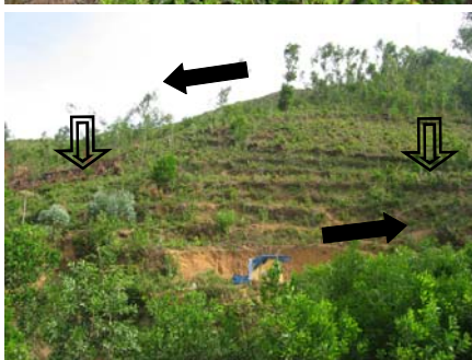
Ảnh 2. Nứt núi Chóp Chài ở đầu phía đông bắc đập phụ hồ Phú Ninh
