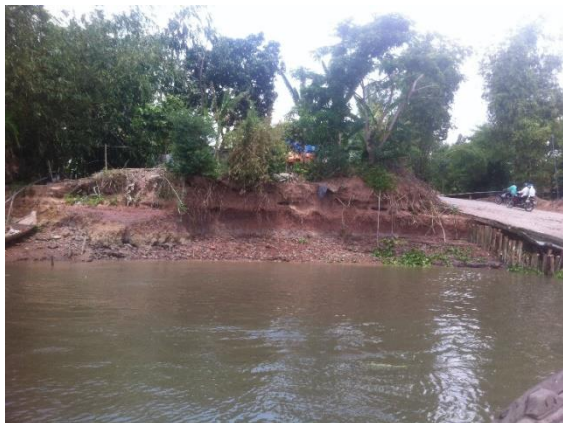
Hình 6. Sạt lở bờ sông Hậu tại Xã An Hòa
