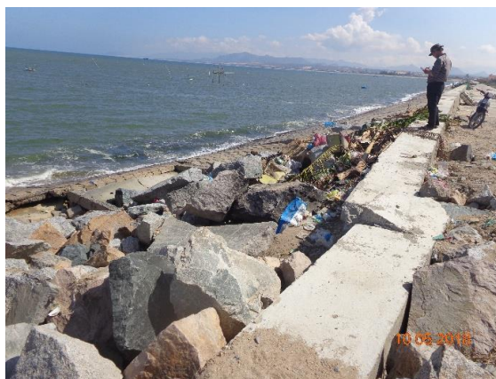
Hình 18. Kè phía nam cửa Đông Hải bị xói lở ở một số đoạn
