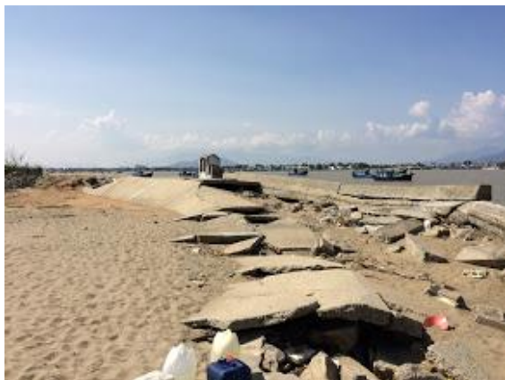
Hình 17. Đoạn kè bờ nam cửa Đông Hải bị xói lở
