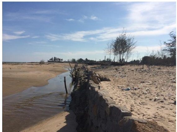
Hình 5. Đoạn bờ phía nam cửa La Gi bị xói lở
