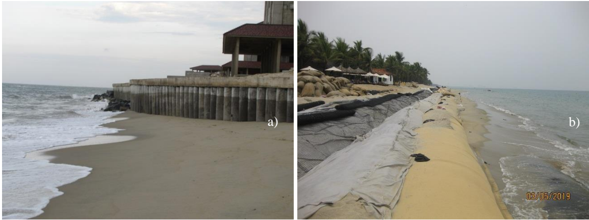
Hình 8. Xói lở đe dọa làm sập đổ công trình (a - 2012), mất đất bãi biển ở phường Cửa Đại (b - 5/2019)
