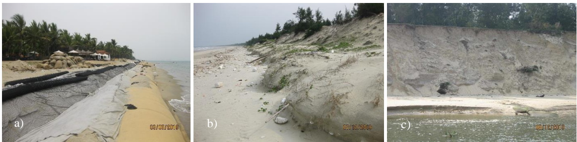
Hình 4. Xói lở mạnh tại bãi biển phường Cửa Đại, Hội An (a - 5/2019), xã Tam Tiến (b) và khu vực Cửa Lờ, Tam Hải, Núi Thành (c - 12/2013)
