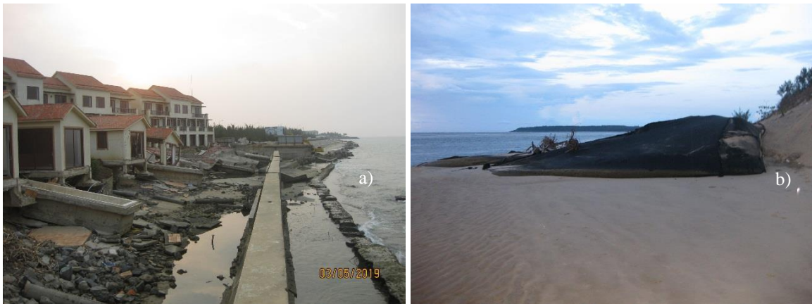
Hình 7. Xói lở làm sập đổ công trình ở phường Cửa Đại (a - 5/2019) và phá hủy công trình kè chống xói lở ở xã Tam Hải (b - 2013)
