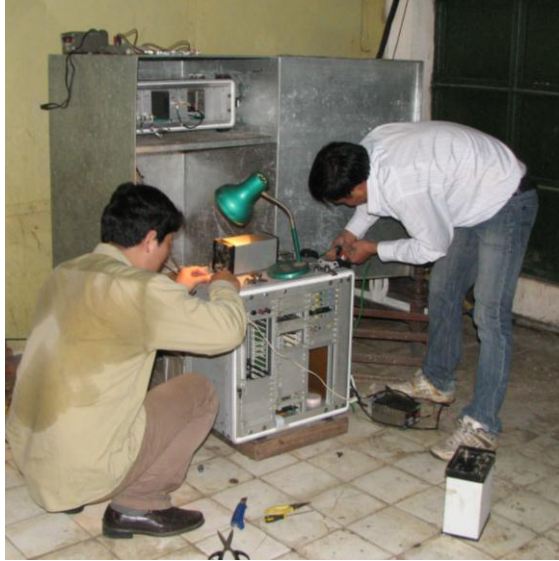
(b) Hệ thống thu - phát và khuếch đại, số hóa tín hiệu động đất tại Trạm trung chuyển Tam Đảo
