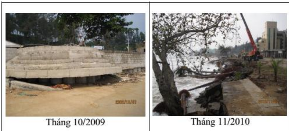
Hình 2. Xói lở tại phía bắc bãi tắm Cửa Tùng [1]
